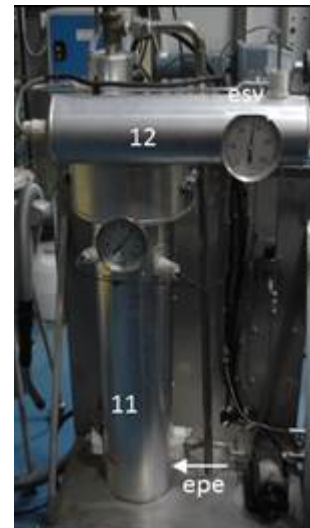
Système de génération de la vapeur surchauffée
